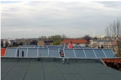
Solarthermische und Photovoltaik-Anlage
